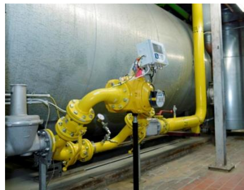
Abbildung: Kesselanlage zur Erzeugung von Fernwärme
