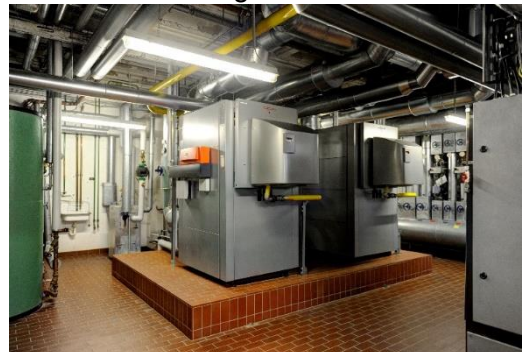
Abbildung: Energiezentrale Hallenbad
